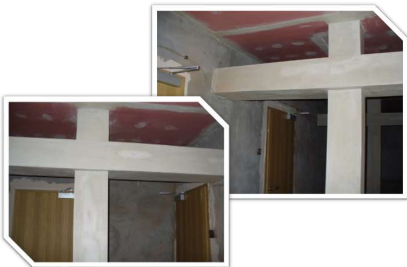
fot. archiwum Urzędu Miejskiego w Toszku – słupy drewniane obudowane płytami kartonowo-gipsowymi ogniochronnymi w budynku Urzędu Miejskiego w Toszku
