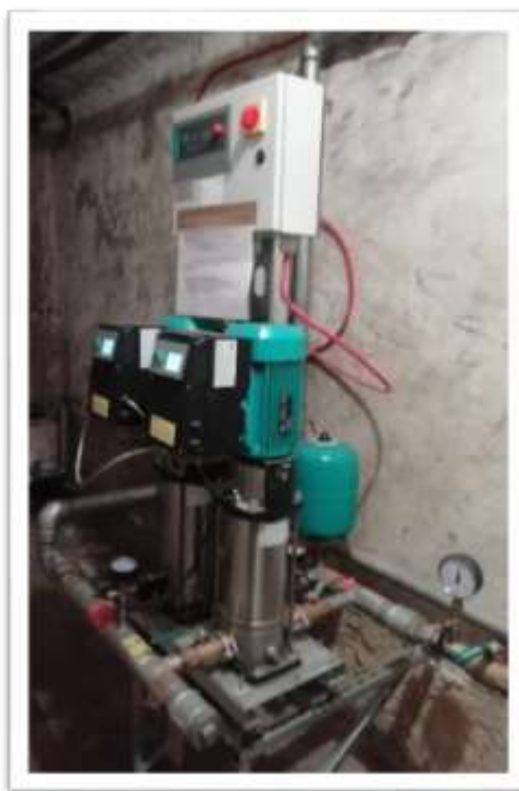
źródło: archiwum Urzędu Miejskiego w Toszku – modernizacja węzła wodomierzowego
