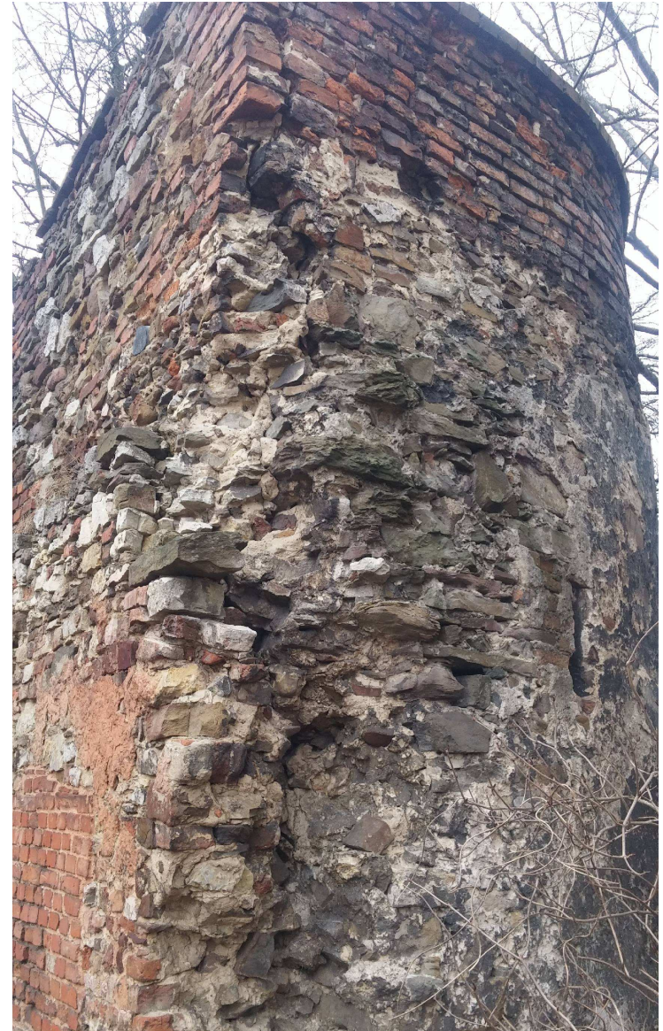
Fot nr 10. Widok uszkodzonego muru bastei.
