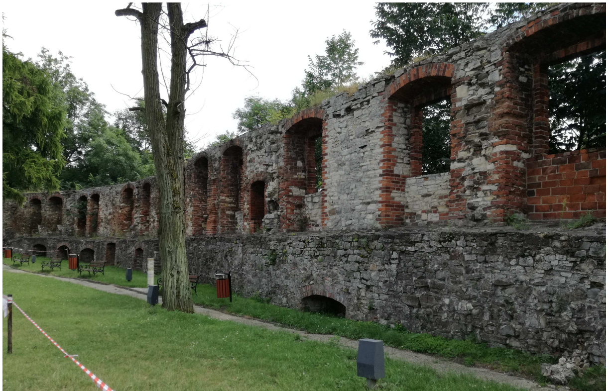
Fot nr 2. Widok osuniętego muru od strony dziedzińca.
