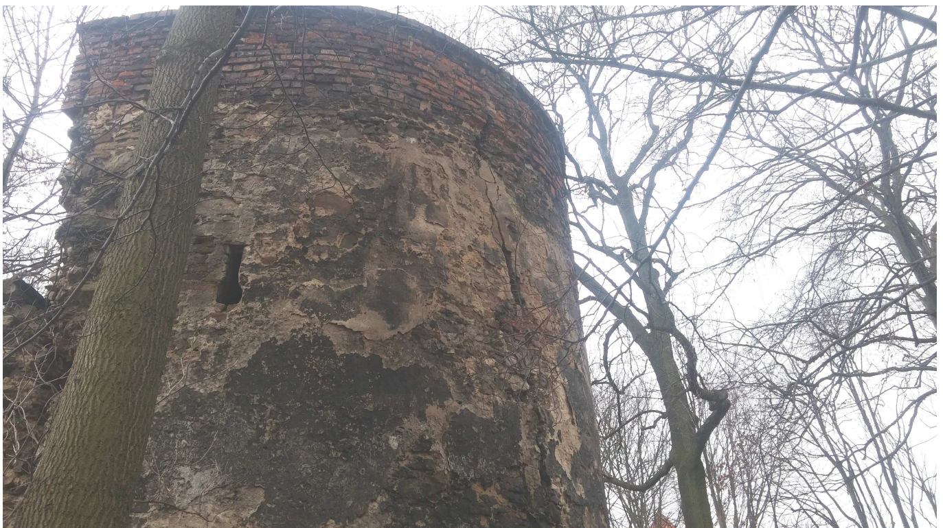
Fot nr 20. Widok spękanego muru bastei.
