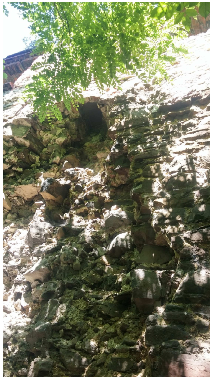
Fot nr 6. Widok osuniętego muru.
