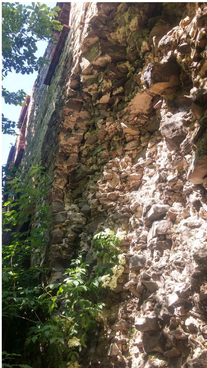
Fot nr 5. Widok osuniętego muru.
