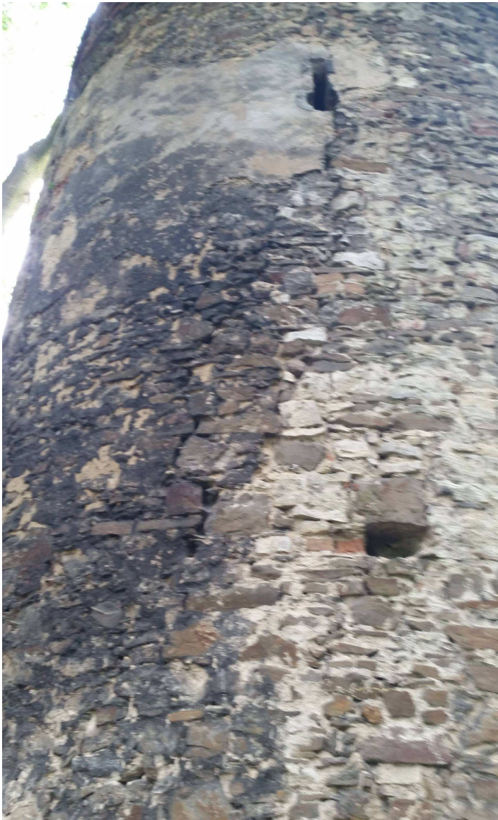
Fot nr 15. Widok spękanego muru bastei.
