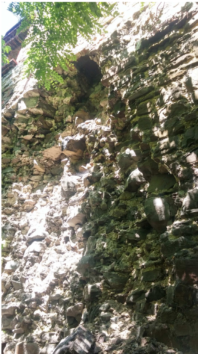
Fot nr 3. Widok osuniętego muru.
