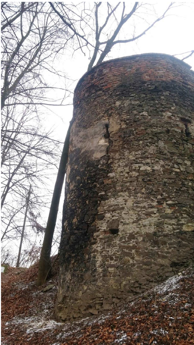
Fot nr 13. Widok spękanego muru bastei.
