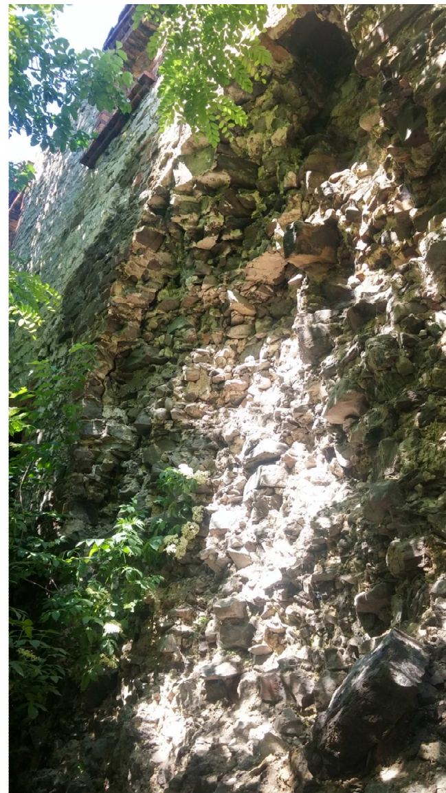
Fot nr 4. Widok osuniętego muru.
