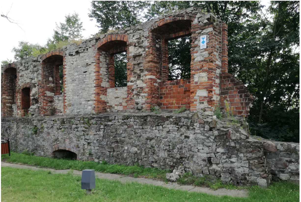
Fot nr 1. Widok osuniętego muru od strony dziedzińca.
