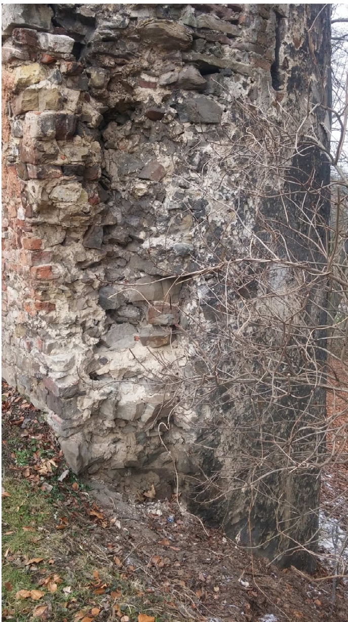
Fot nr 11. Widok uszkodzonego muru bastei.
