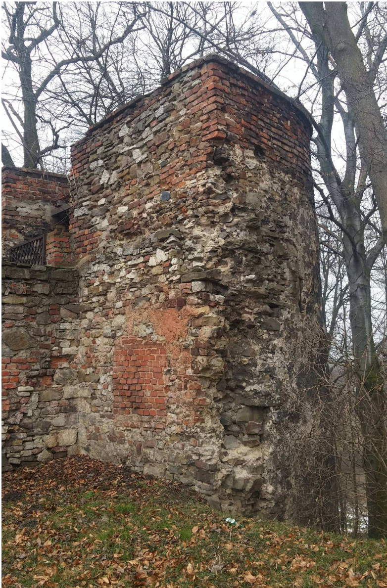
Fot nr 9. Widok uszkodzonego muru bastei.
