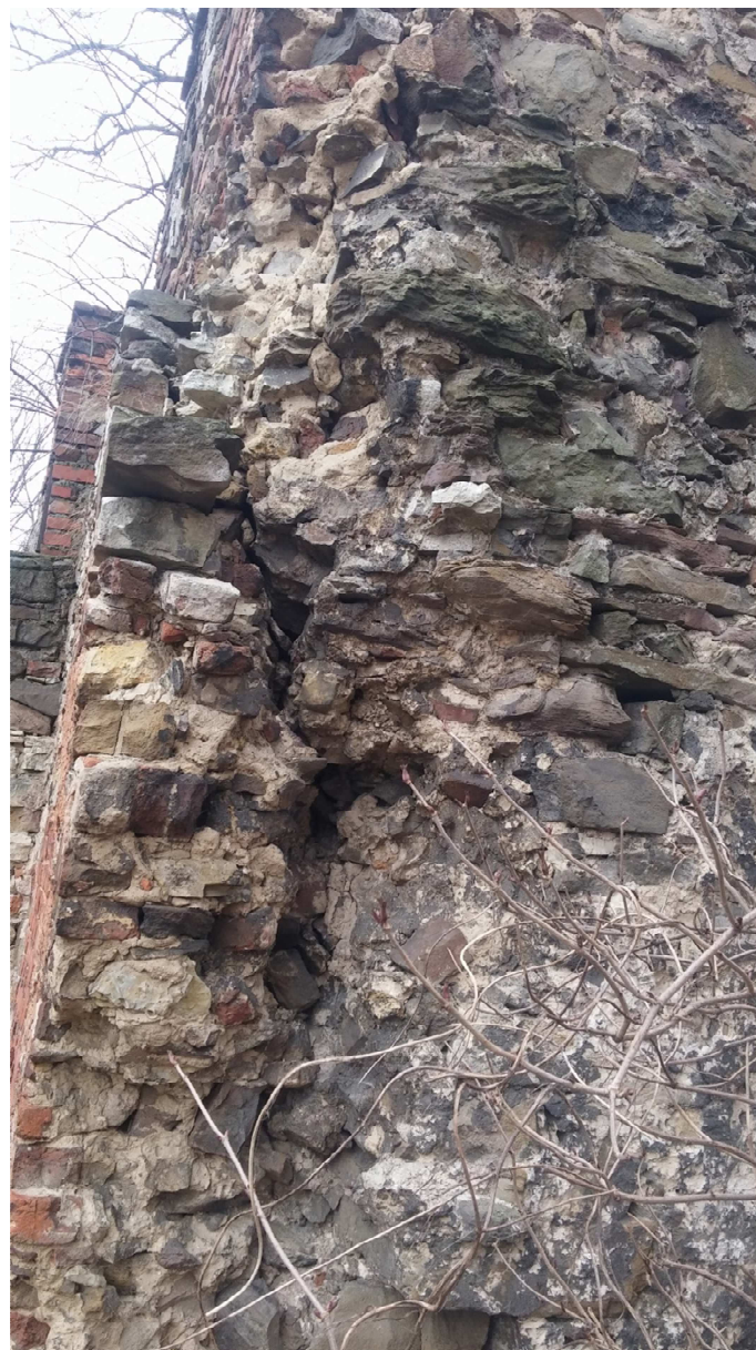
Fot nr 12. Widok uszkodzonego muru bastei.
