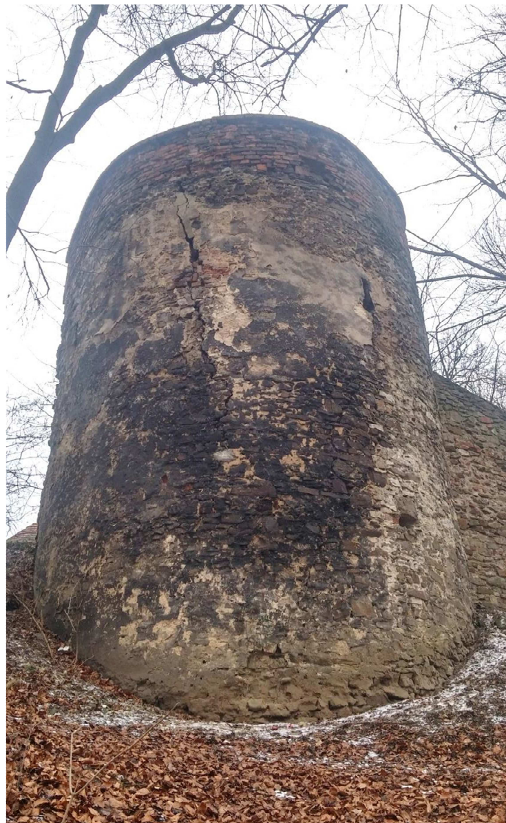
Fot nr 14. Widok spękanego muru bastei.
