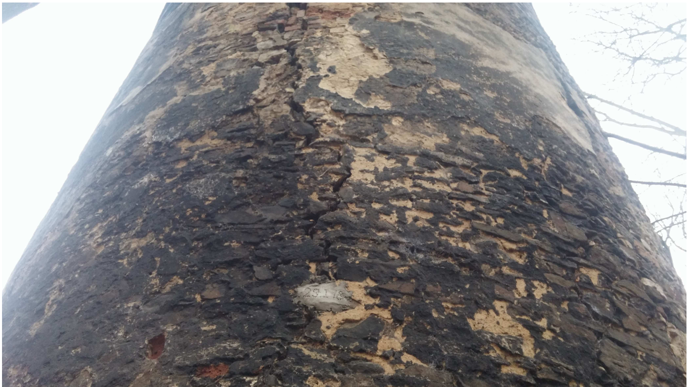
Fot nr 19. Widok spękanego muru bastei.
