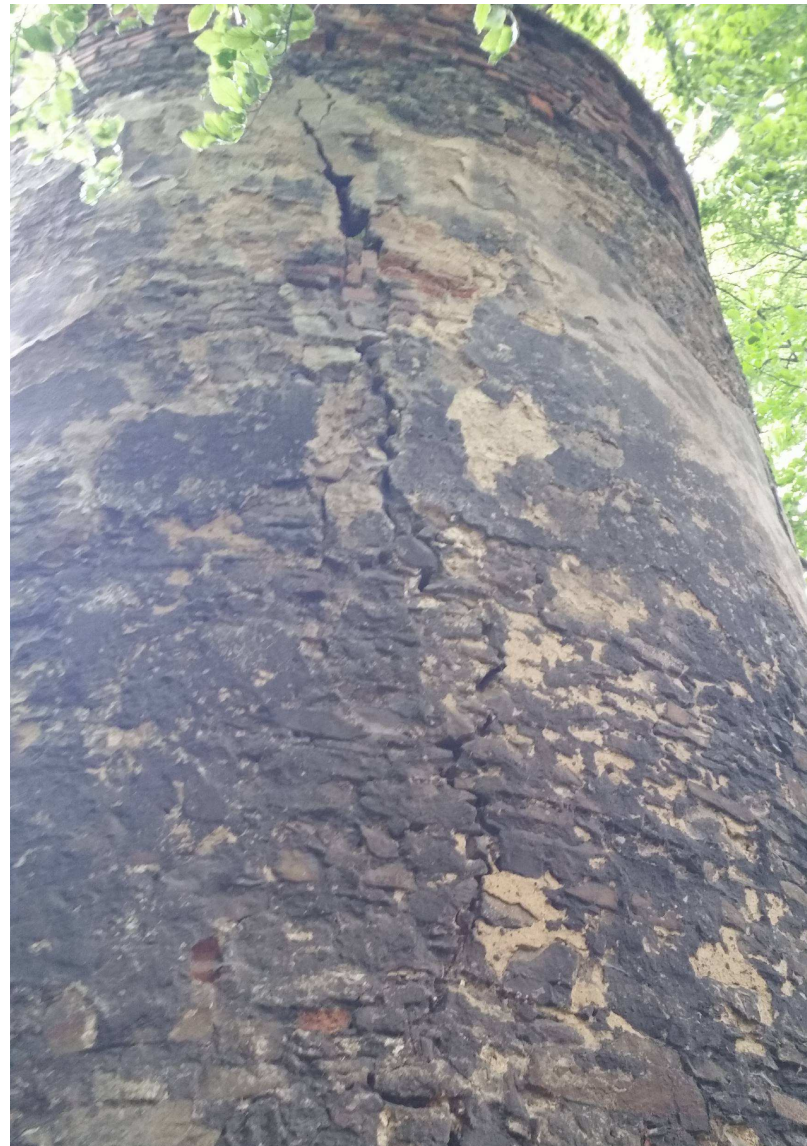
Fot nr 16. Widok spękanego muru bastei.
